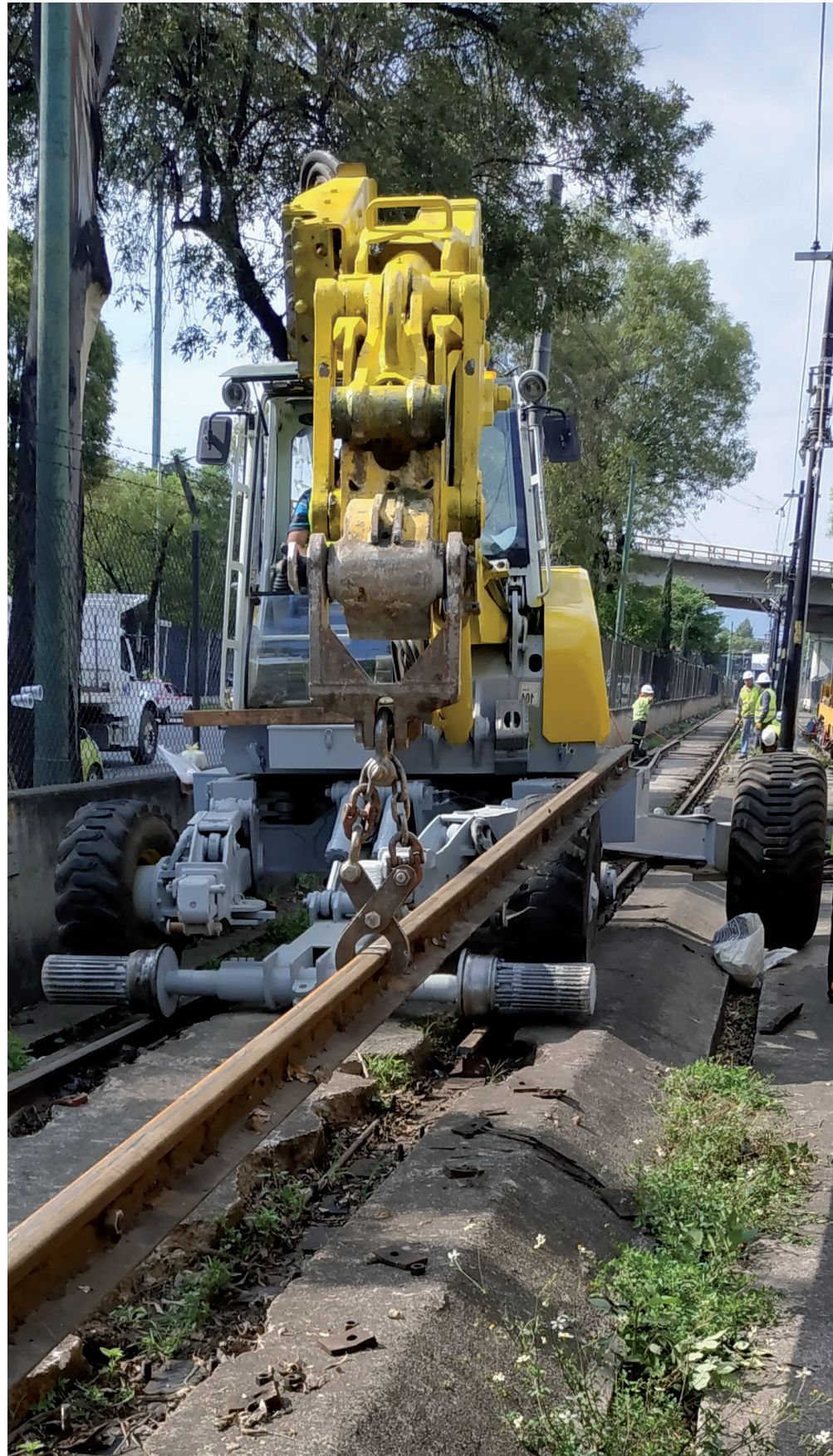
Trabajos de mantenimiento de vía del Tren Ligero. Fuente: Servicio de Transportes Eléctricos
